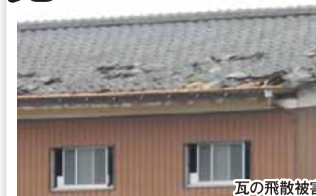
瓦の飛散被害
