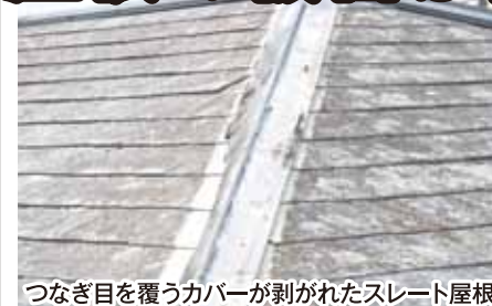
つなぎ目を覆うカバーが剥がれたスレート屋根
