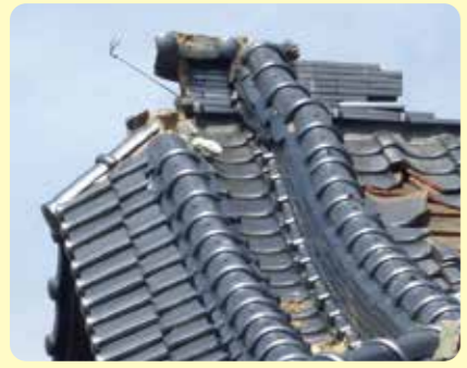
棟が崩れている
