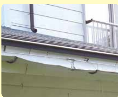
雨樋が壊れている
